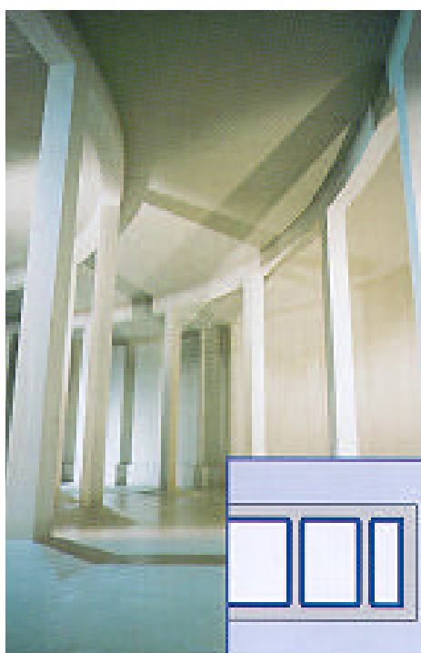
Δεξαμενές πόσιμου νερού.
